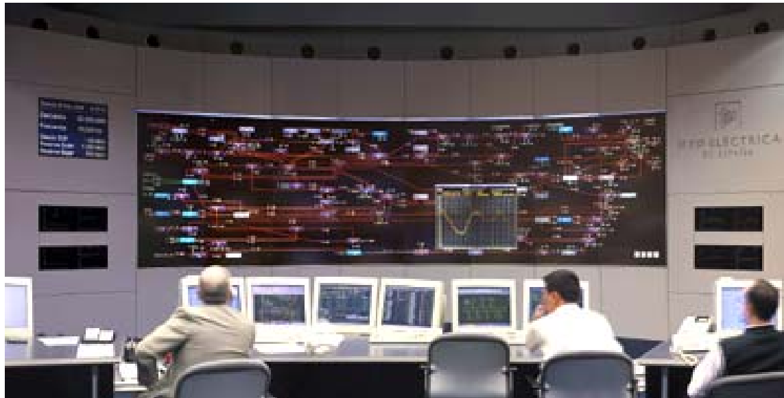
Centro de Control Eléctrico de Red Eléctrica (CECOEL)
